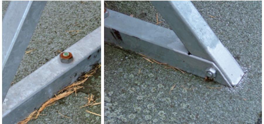
Korrosion ist zu vermeiden
