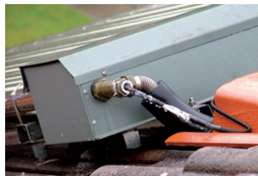
Fühlerkabel nicht befestigt
