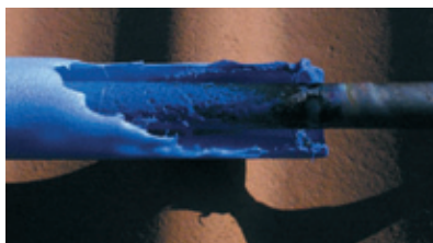
Bild 1: Aus der Heizungstechnik übliche Wärmedämmung ist für Solaranlagen nicht geeignet
