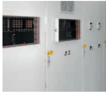
Von links nach rechts: Gasbrenner, Heizkreisverteilung, Schaltanlage
