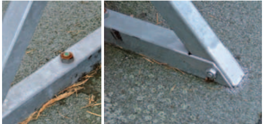
Korrosion ist zu vermeiden
