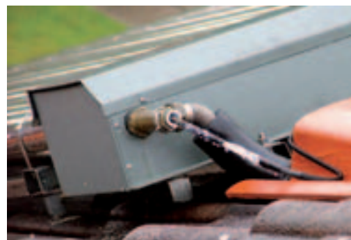
Fühlerkabel nicht befestigt
