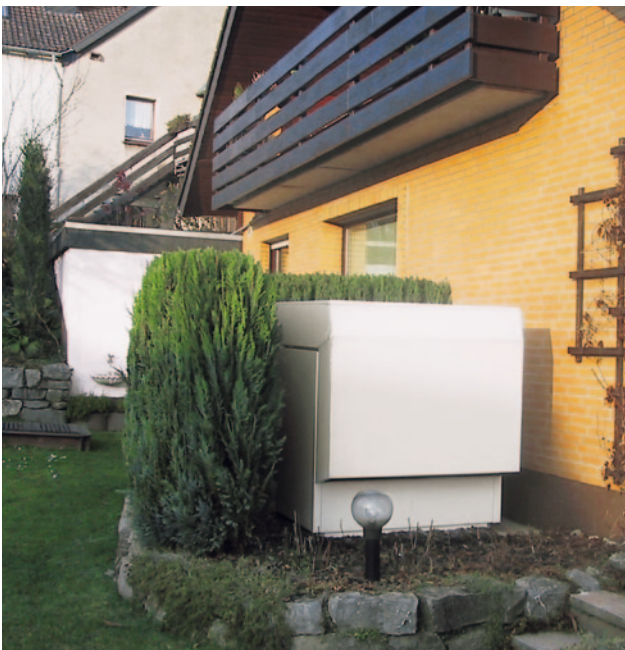
Aussen aufgestellte Wärmepumpe
