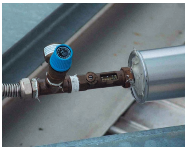
Bild 6: Nicht geeignet für den Einbau in unmittelbarer Kollektornähe: Sicherheitsventil und Durchflussmengenbegrenzer ohne ausreichende thermische Beständigkeit für die gewählte Einbauposition
