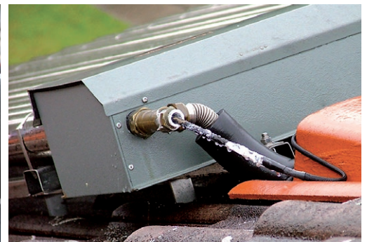
Fühlerkabel nicht befestigt
