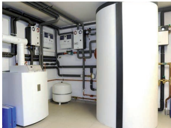
Abb. 18: Brennwertanlage mit Pufferspeicher
