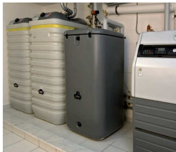
Abb. 11: Platzsparende, oberirdische Lagerung neben dem Brennwertkessel
