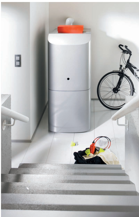
Abb. 6: Neue Ölbrenn- wertheizung
