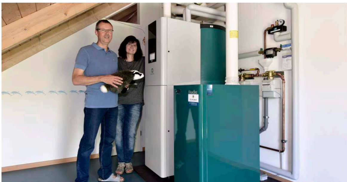
Abb. 1: Das Brennstoffzellenheizgerät erzeugt Wärme und Strom im Wohnhaus
