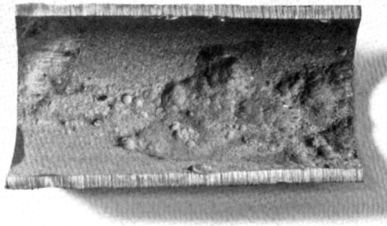
Ausgeprägte Mulden infolge Sauerstoffkorrosion in einem Rohr aus St 37 nach Entfernung der Korrosionsprodukte
