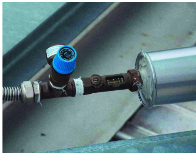
Bild 6: Nicht geeignet für den Einbau in unmittelbarer Kollektornähe: Sicherheitsventil und Durchflussmengenbegrenzer ohne ausreichende thermische Beständigkeit für die gewählte Einbauposition
